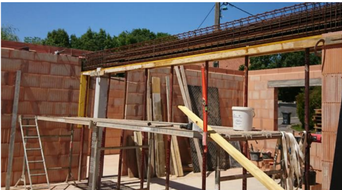
Figure 3.26. Les maçons n'ont ici pas installé les garde-corps sur cette plate-forme, sinon, ils ne pourraient se passer des charges et des outils, ni même monter correctement dessus.
