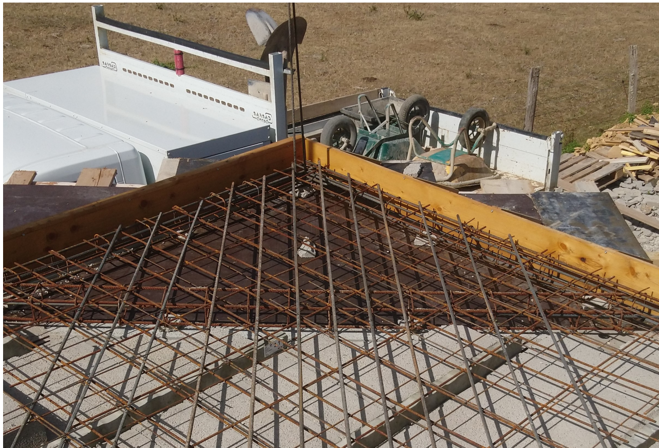
Figure 2.15. Chute de parpaing servant de cale pour le ferrailage
