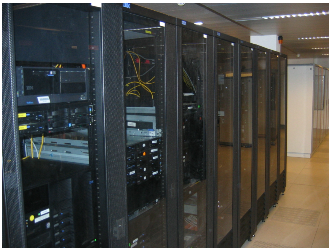
FIGURE 5.8 – Illustration d'une armoire de serveur où l'on voit clairement les racks
